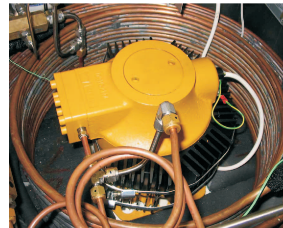
Ausschnitt der CO 2 -Wärmepumpe: Verdampfer und Verdichter mit Kühlrippen
