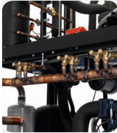
Valvole di sicurezza con collettore. Liquid safety valves.
