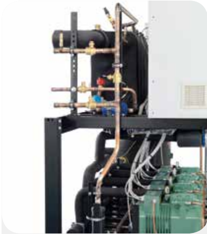
By-pass desurriscaldatore ad aria con silenziatore. By-pass desuperheater with muffler.
